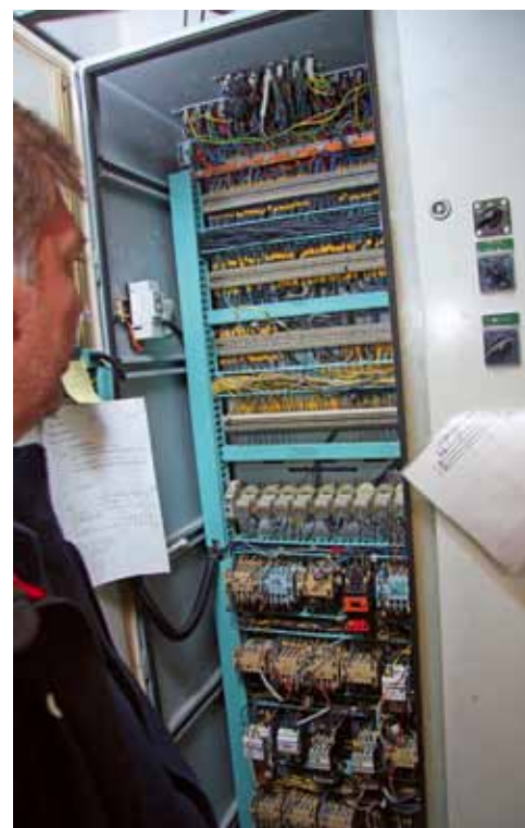
Ett vanligt kopplingskåp, modell äldre, kanske bör bytas ut mot något mer modernt.
